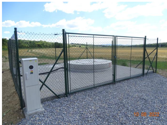
Kanalizácia obce – prečerpávací stanica (r. 2022)
